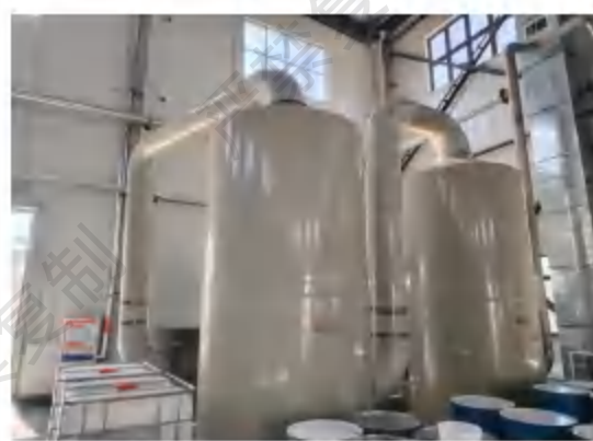
二级碱喷淋塔
