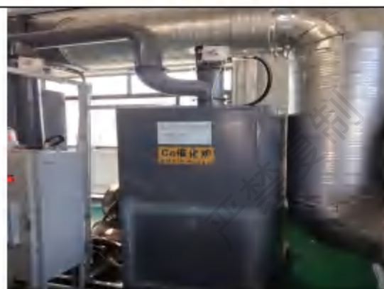
CO 催化燃烧炉
