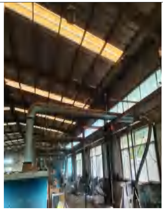
粉尘收集管道
