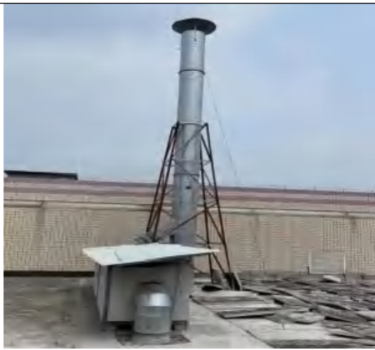
过滤棉+二级活性炭处理设施+DA003 排气筒
