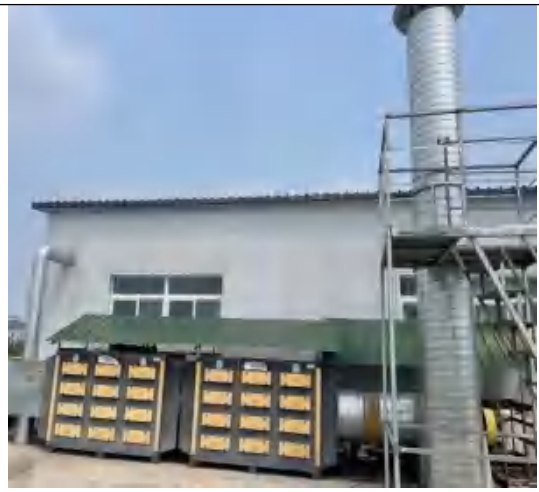
过滤棉+二级活性炭处理设施+DA005 排气筒
