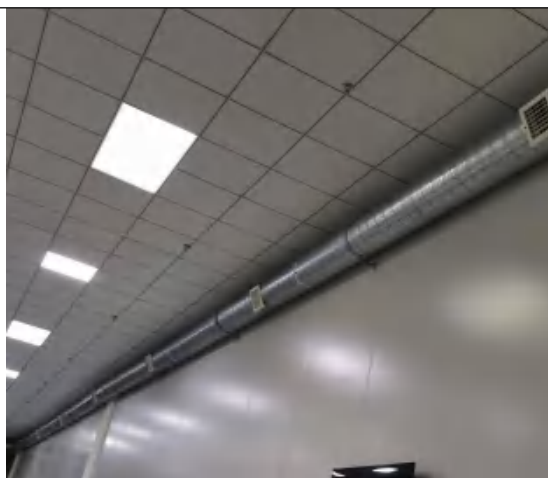
硅胶押出生产线废气收集管道
