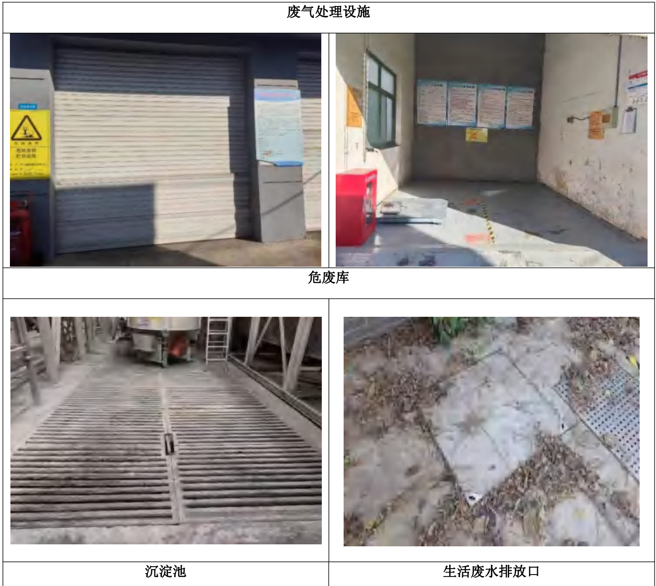
图 4-1 生产设施、环保设施相关内容
