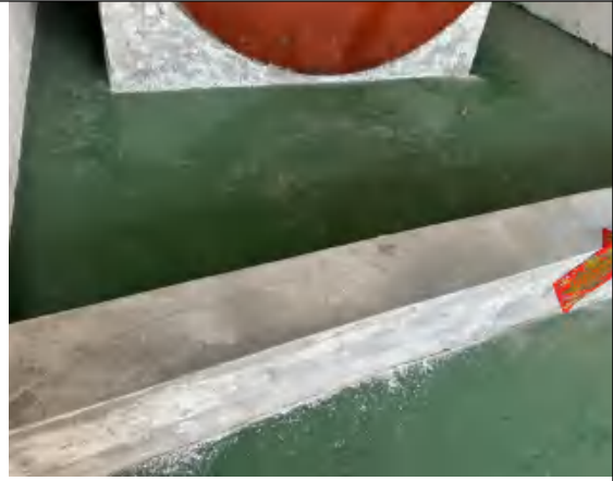
储油罐设置围堰
