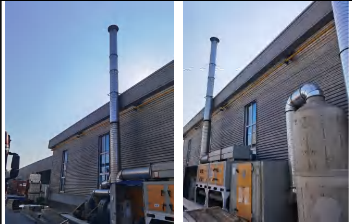
喷淋塔+干式过滤器+活性炭吸脱附+催化燃烧+排气筒 P1
