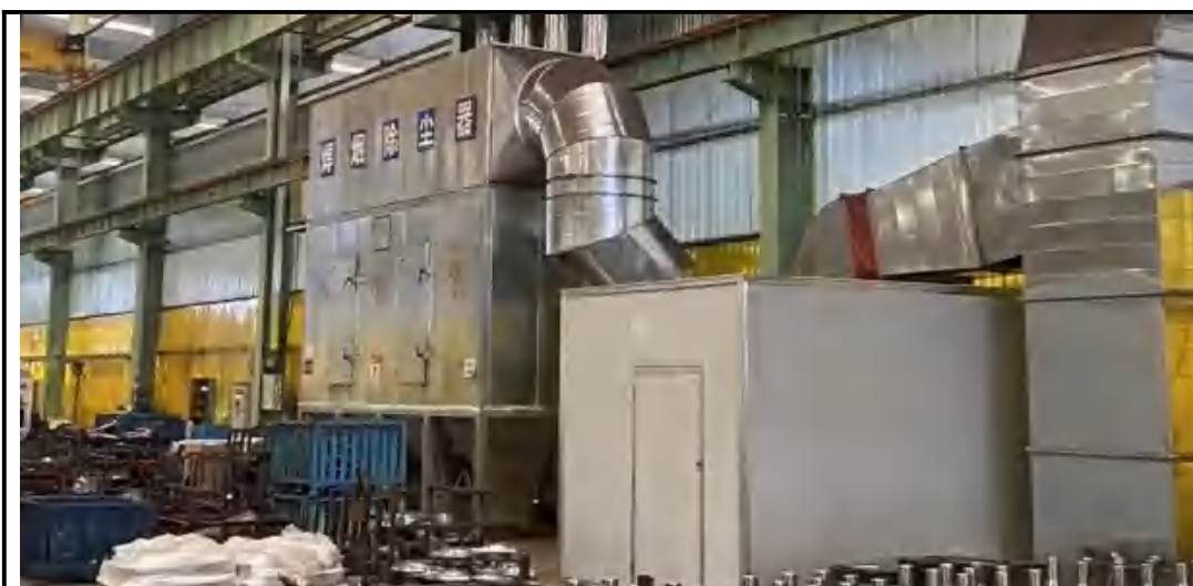
大抛丸废气处理设施：滤筒式袋式除尘器
