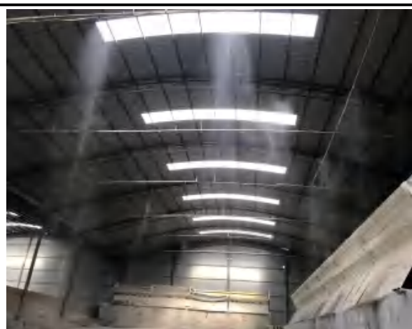
密闭车间内喷淋装置
