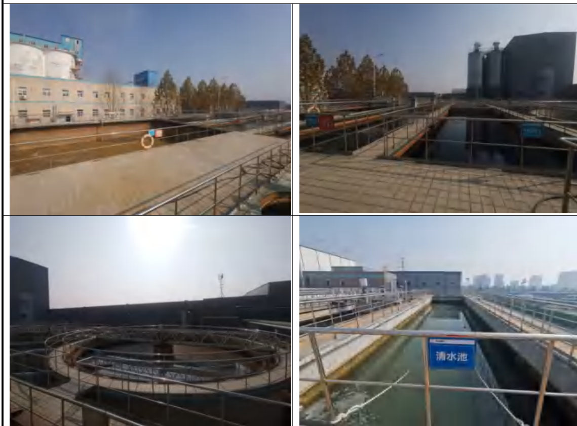
污水处理站现场照片
