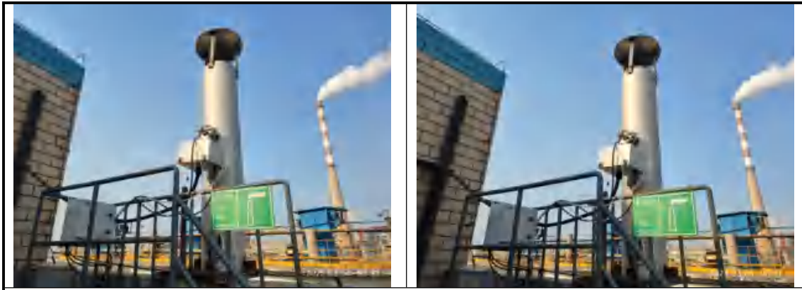
VOCs 废气治理设施
