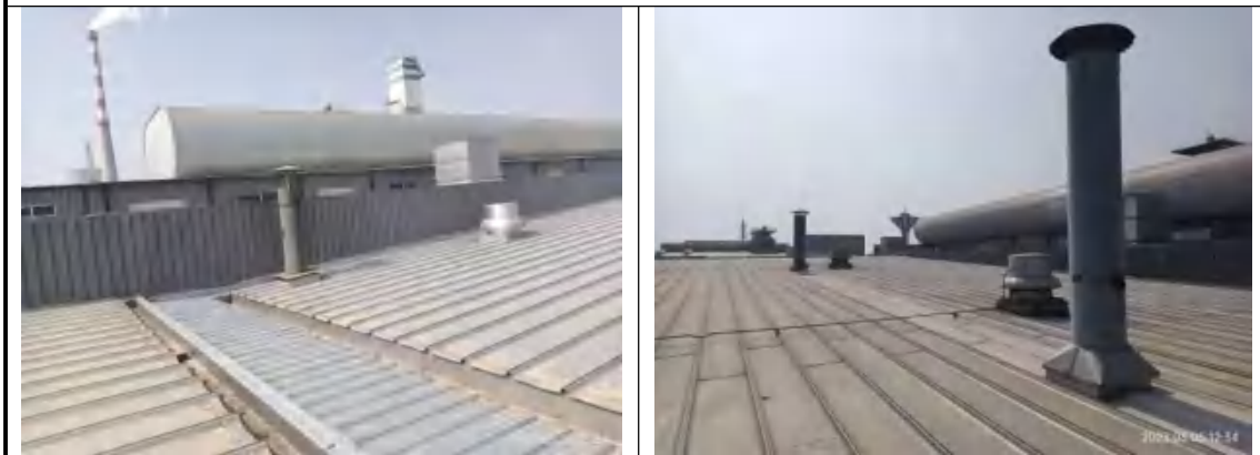
烘干废气排气筒
