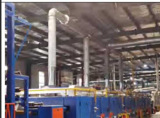
工艺废气喷淋塔
